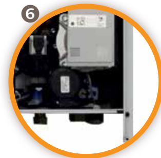
Valvola 3 vie posta sul ritorno riscaldamento
