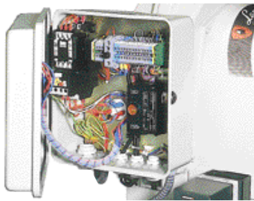
Quadro elettrico antiurto
