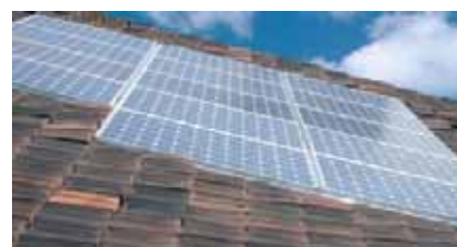
Impianto con integrazione architettonica, o totalmente integrato
