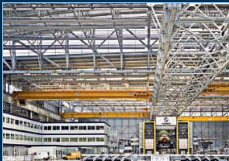
TERMOSTRISCE RADIANTI DUCK STRIP : AEROSPATIALE TOULOUSE FABBRICA DEL NUOVO AEREOPLANO AIRBUS A380 ALTEZZA DI INSTALLAZIONE: 40 m
