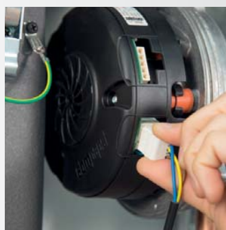
Disconnessione elettrica ventilatore
