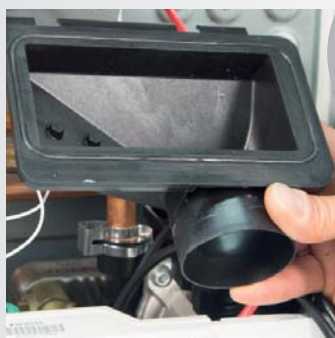
Ispezione raccolta condensa
