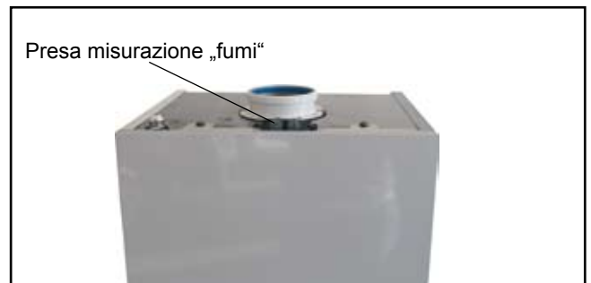
Figura: analisi fumi con caldaia chiusa
