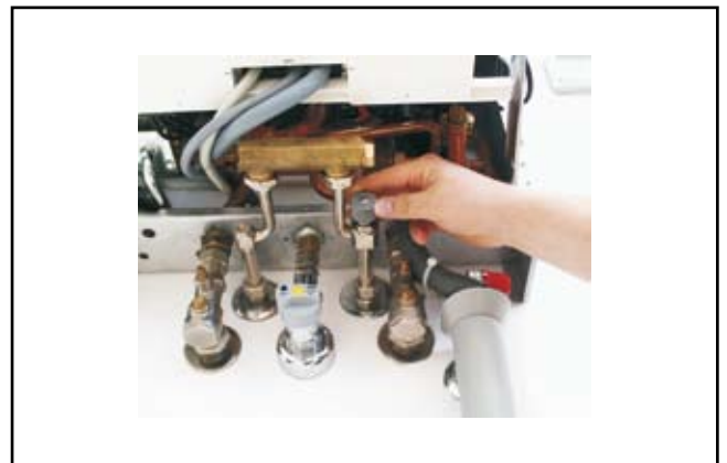
Figura: caldaia con produzione di acqua calda
