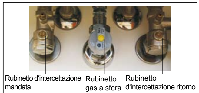
Figura: dispositivi di intercettazione
