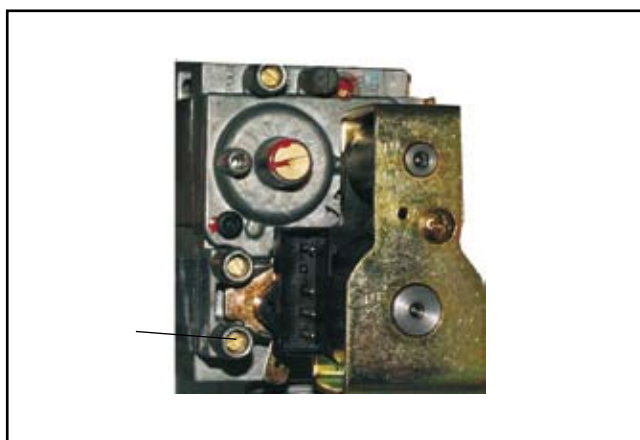
Figura: controllo pressione di allacciamento gas
