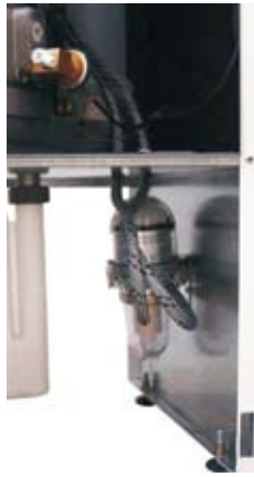
Filtro gasolio montato in caldaia
