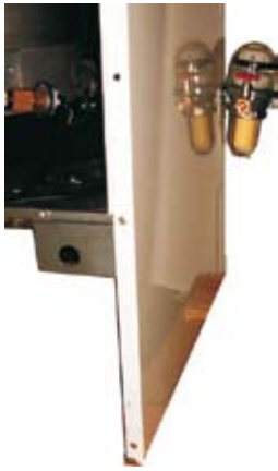
Filtro gasolio montato esterno alla caldaia
